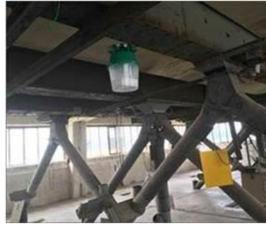
Monitoring auch im Siloraum
